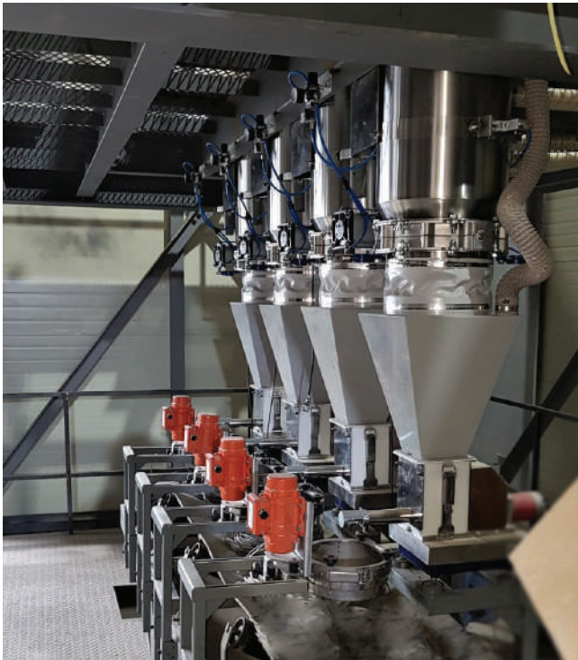
System transportowy i dozujący do barwienia na sucho. Zespół 4 podajników w linii na tej samej prasie.
