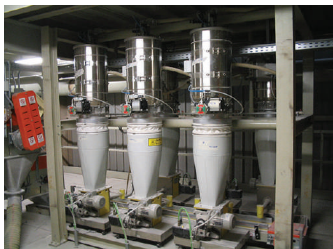
Система транспортировки и дозирования материалов для сухого крашения. Батарея из 6 дозаторов.
