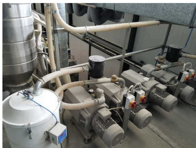
Многоступенчатая насосная станция.
