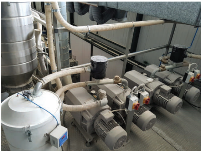
Unidad de bombeo múltiple.
