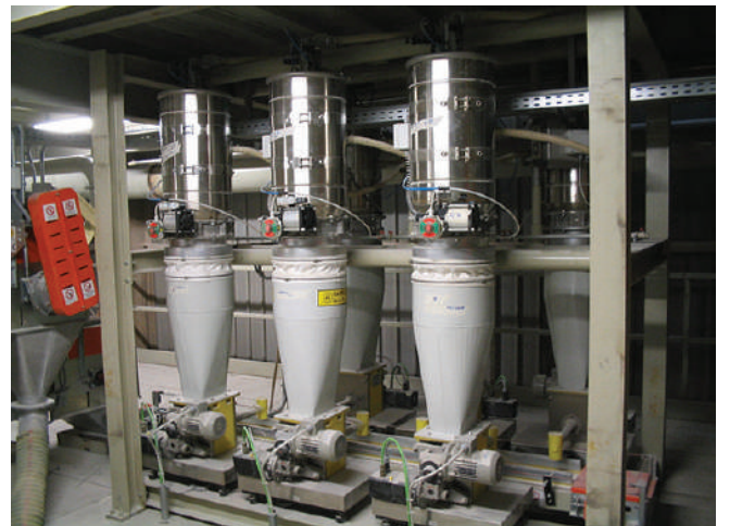
Sistema de transporte y dosificación para tintura en seco. Batería de 6 dosificadores.
