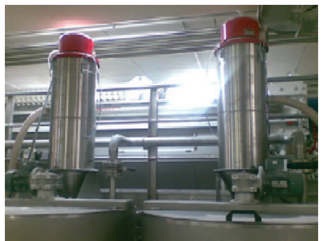
Sistema compuesto por dos transportadores monofásicos que cargan dos depósitos para la preparación del compuesto filtrante de harina fósil.
