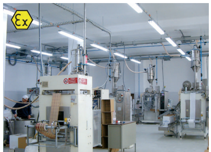
Sistema de transporte neumático centralizado sobre un total de 9 máquinas envasadoras con extracción de 4 big-bags en una industria de envasado del azúcar. Sistema realizado en versión ATEX por zona 22.
