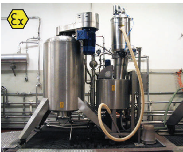
Sistema de transporte de perlita, de aire comprimido por zona ATEX 1-2 sobre una unidad filtrante en una extensión.
