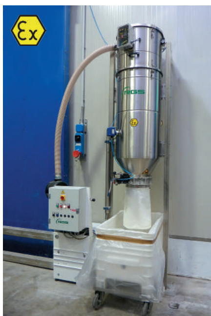
Sistema de transporte neumático centralizado para harinas y residuos de elaboración en una pizzería industrial. Sistema realizado en versión ATEX por zona 22 polvos.
