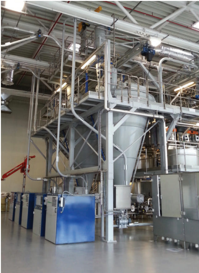
Compresores de presión para el transporte de polvo de tabaco.
