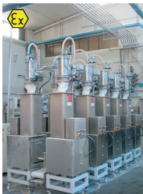
Instalación de transporte y dosificación con gestión de recetas (10 productos) en una panadería industrial. Sistema realizado en versión ATEX por zona 22 polvos.
