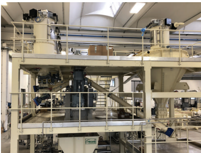
Instalación de transporte neumático para polvos de tabaco, almacenamiento en silo y dosificación sobre mezclador.
