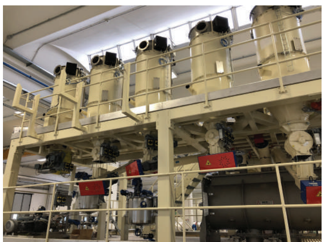
Instalación de transporte neumático para polvos de tabaco, almacenamiento en silo y dosificación sobre mezclador.
